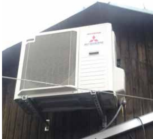
Klimaanlage für die Bücherei
